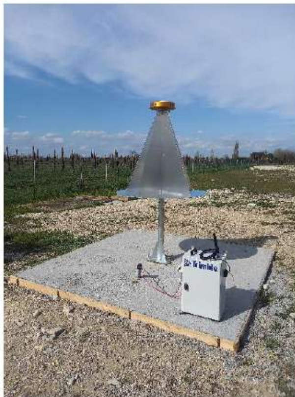
Figura 5.3.1: sito di installazione della stazione GNSS a doppia frequenza LONG.
