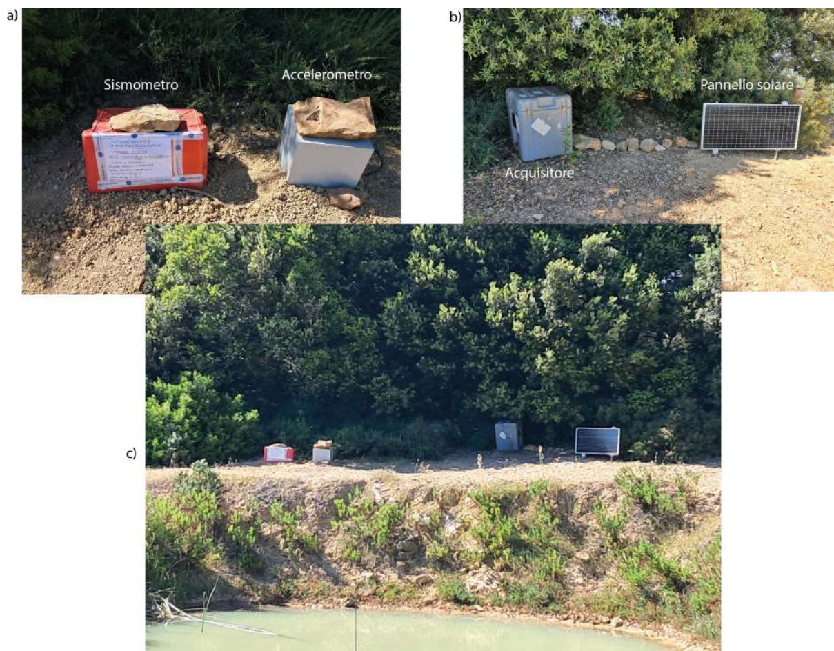
Figura 2.12: Stazione VAIA: a) Posizionamento dei sensori sismici, b) veduta del box di acquisizione (provvisto di acquisitore, batteria di alimentazione e GPS) e pannello solare, c) panoramica del sito della stazione VAIA.
