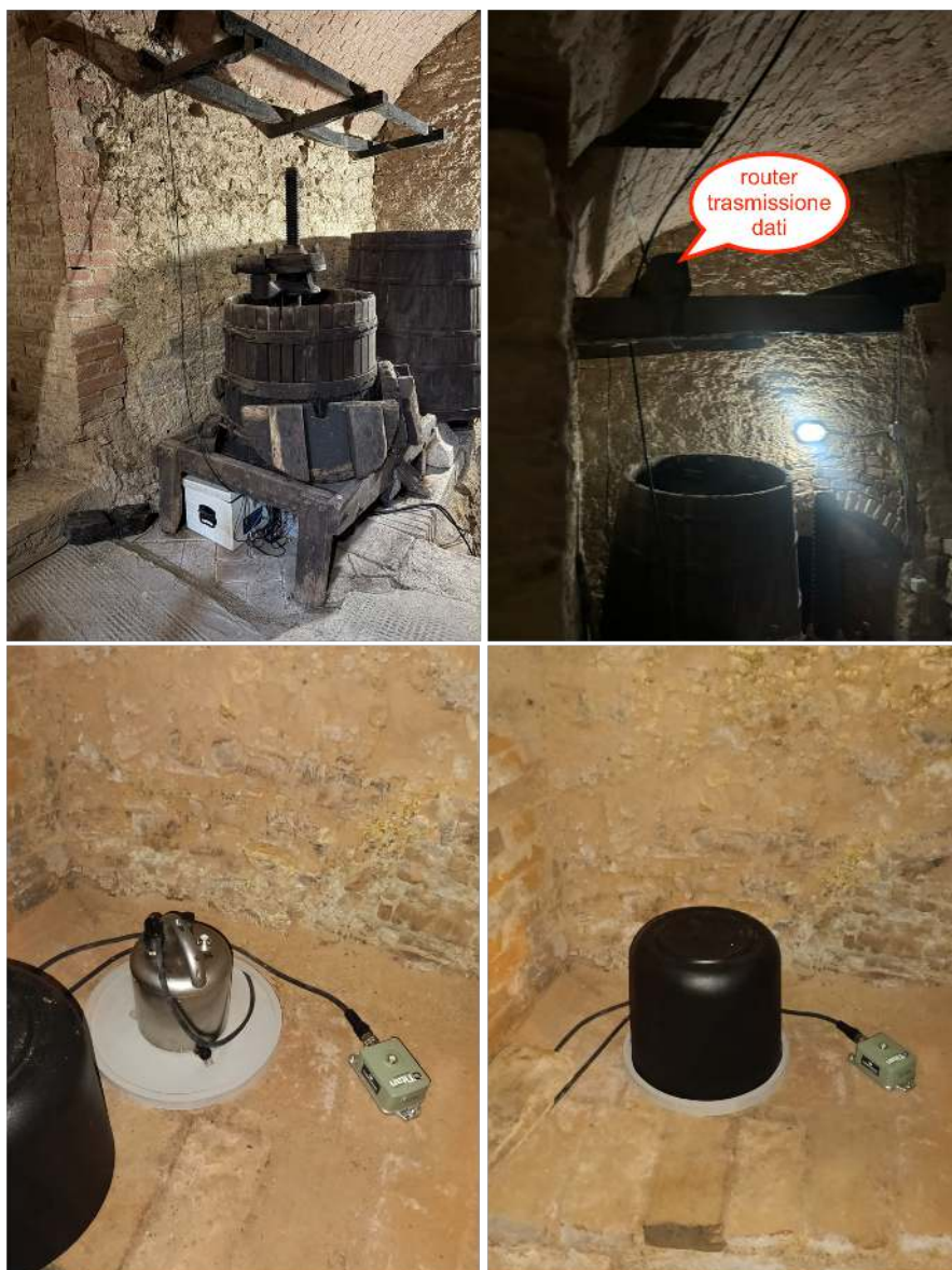
Figura 2.9: Acquisitore, modem LTE, posizione sensore sismico a larga banda e accelerometro senza e con copertura termoisolante
